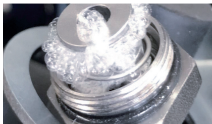
Εικόνα 1: Πολυμερισμένο ψυκτικό μέσο στο εξάρτημα σύνδεσης
